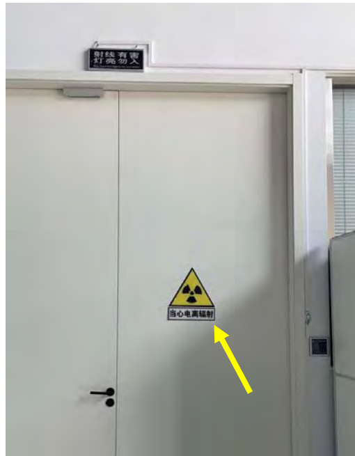
出入门上张贴电离辐射警告标志
