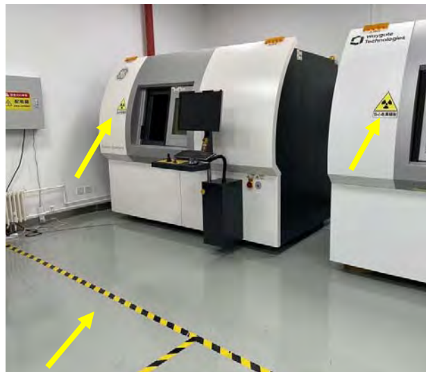
设备上电离辐射警告标志以及设备周边 1 米处警戒线
